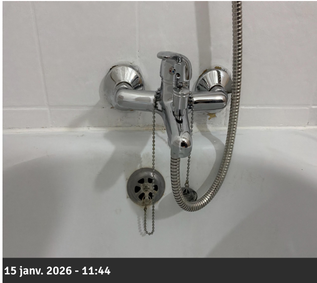
Photo 46 • Salle de bains / Robinetterie
