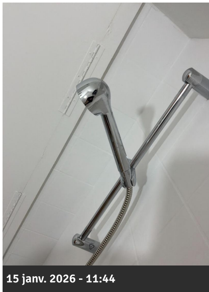
Photo 48 • Salle de bains / Robinetterie
