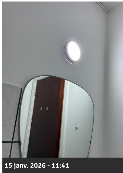
Photo 29 • Salle de bains / Point lumineux
