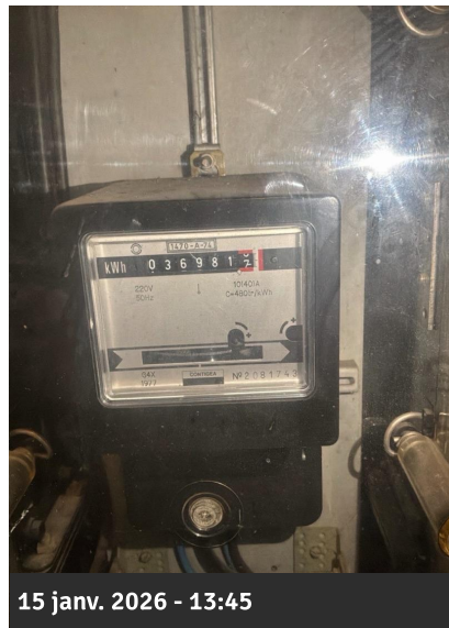
Photo 5 • Compteur / Electricité (HP)
