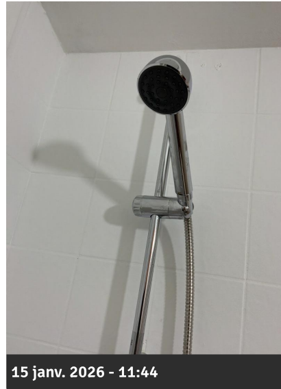
Photo 47 • Salle de bains / Robinetterie
