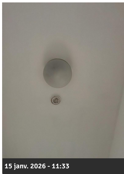
Photo 121 • D'entrée / Point lumineux
