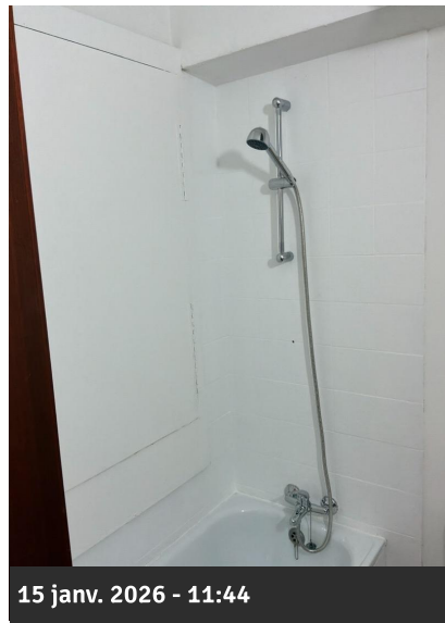
Photo 49 • Salle de bains / Robinetterie
