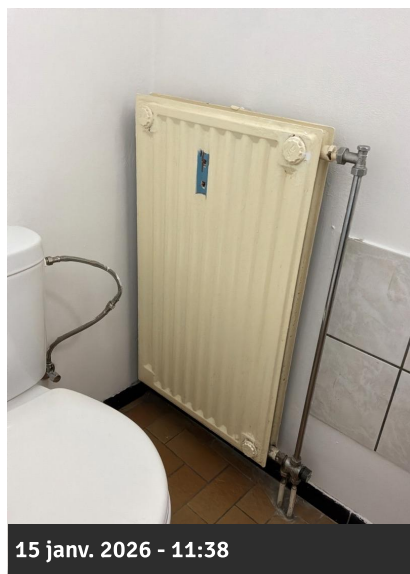
Photo 26 • Salle de bains / Radiateur
