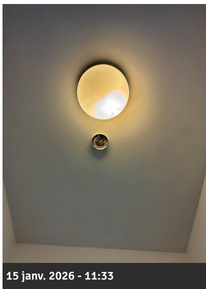
Photo 120 • D'entrée / Point lumineux
