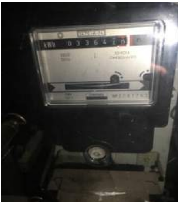
Photo 3 (Compteur / Electricité (jour))
