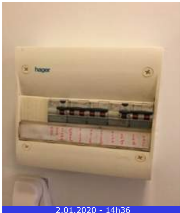
Photo 16 (Hall / tableau électrique / Bon état)
