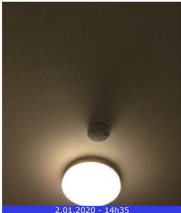
Photo 15 (Hall / détecteur incendie / Bon état)
