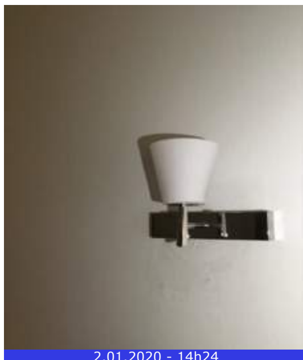
Photo 57 (Salle de bains / Point lumineux / Bon état)
