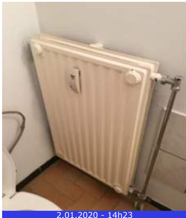
Photo 54 (Salle de bains / Radiateur(s) / Bon état)
