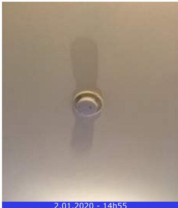
Photo 33 (Séjour / détecteur incendie / Bon état)
