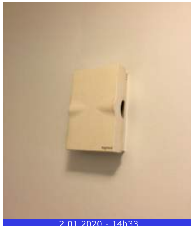
Photo 10 (Hall / Sonnette / Bon état)
