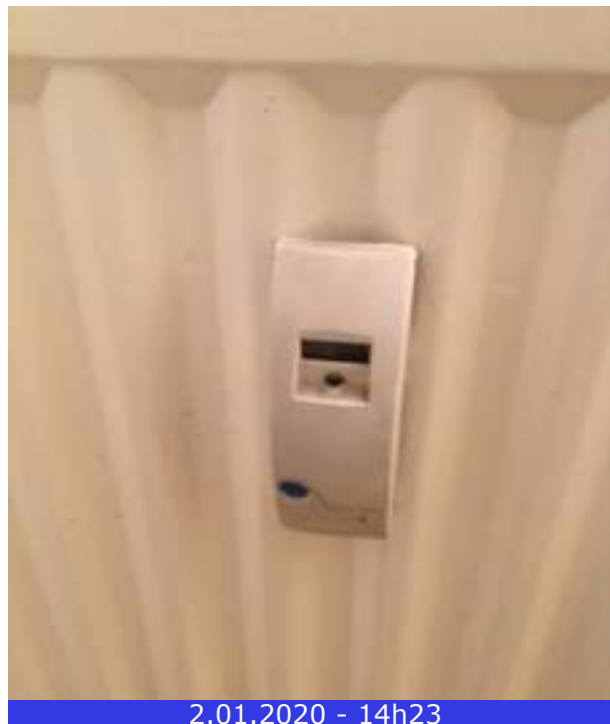
Photo 55 (Salle de bains / Radiateur(s) / Bon état)
