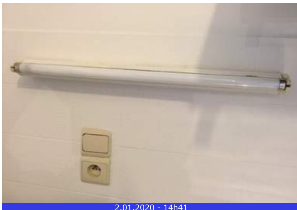
Photo 35 (Cuisine / Point lumineux / Ne fonctionne plus)
