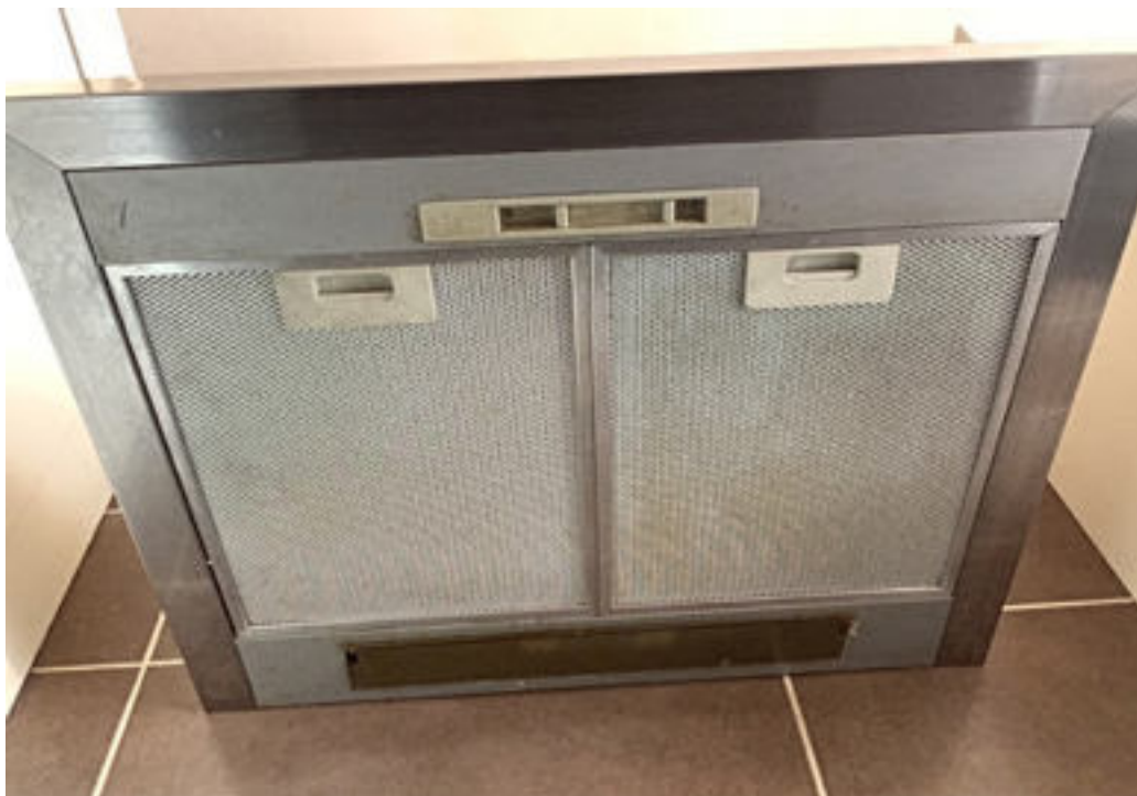
Photo 66 (Cuisine / Hotte aspirante / Bon état)
