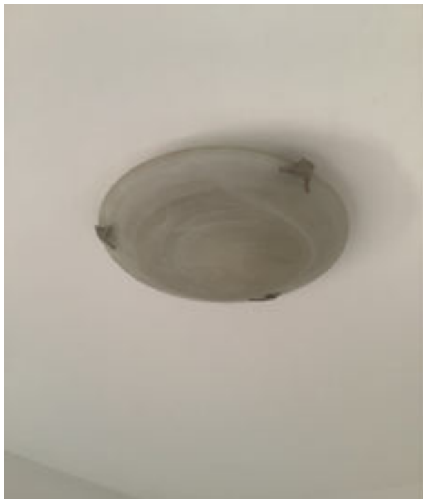
Photo 15 (Hall / Point lumineux / Bon état)
