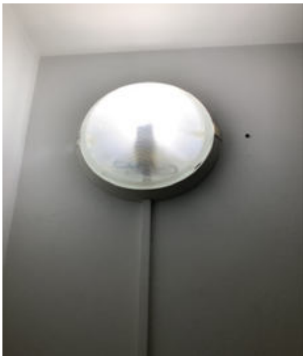
Photo 101 (Salle de bains / Point lumineux / Bon état)
