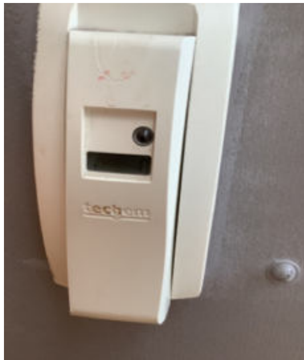
Photo 29 (Séjour / Radiateur(s) / Bon état)
