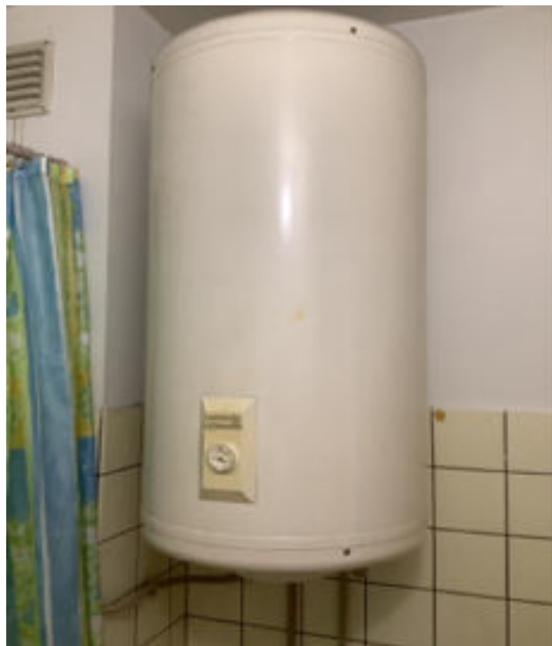
Photo 113 (Salle de bains / boiler électrique / Hors d'usage)
