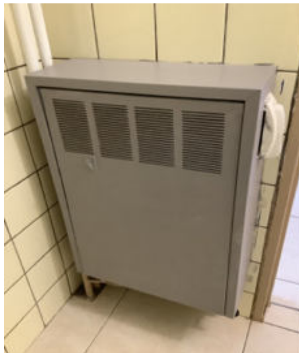
Photo 98 (Salle de bains / Radiateur(s) / Bon état)
