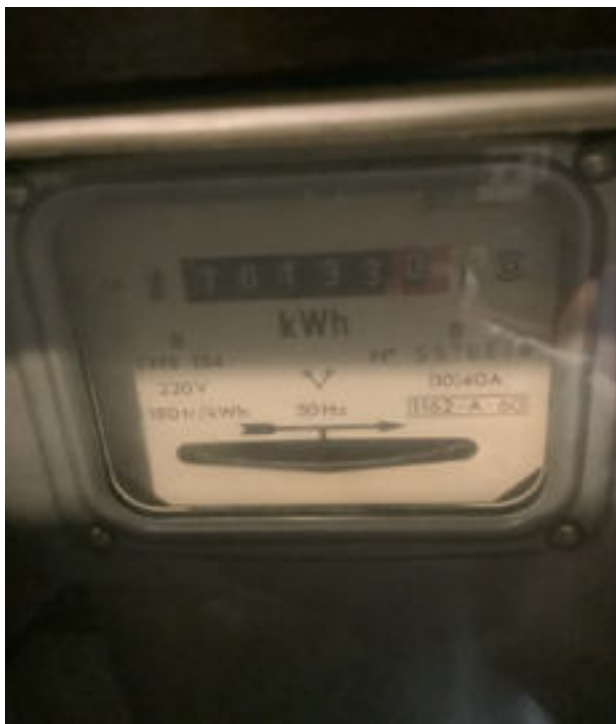
Photo 1 (Compteur / Electricité (HP))
