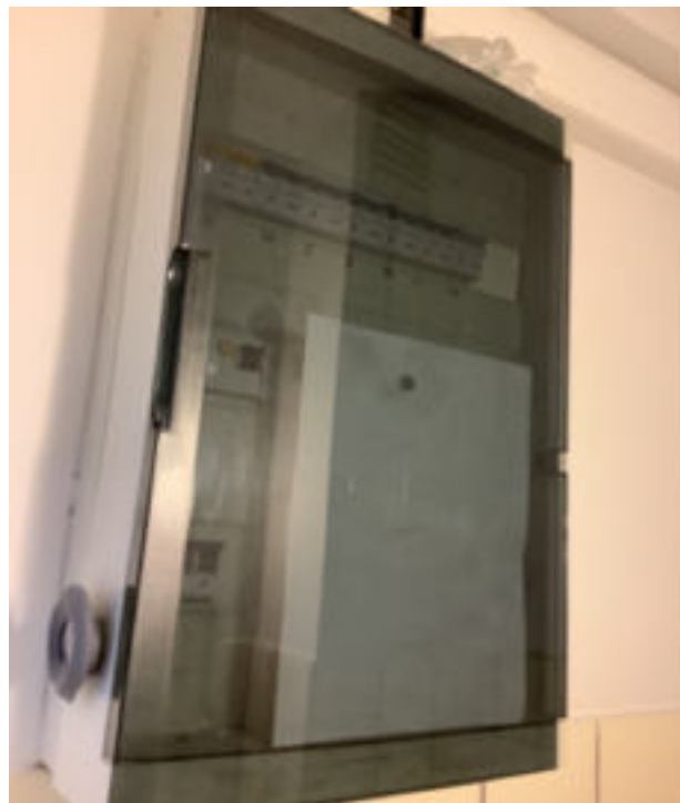
Photo 87 (WC / tableau électrique / Bon état)
