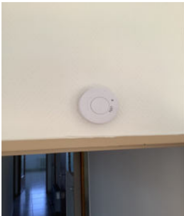
Photo 41 (Séjour / détecteur incendie / Bon état)
