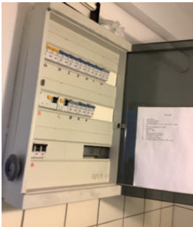
Photo 88 (WC / tableau électrique / Bon état)
