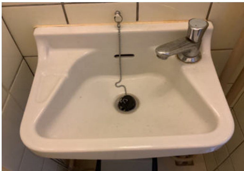
Photo 83 (WC / Lavabo / Etat d'usage)
