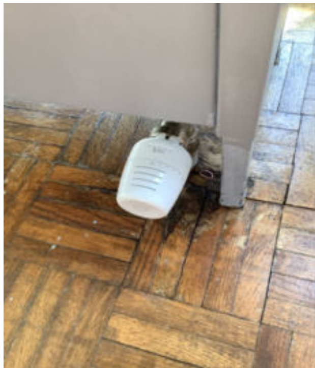
Photo 28 (Séjour / Radiateur(s) / Bon état)
