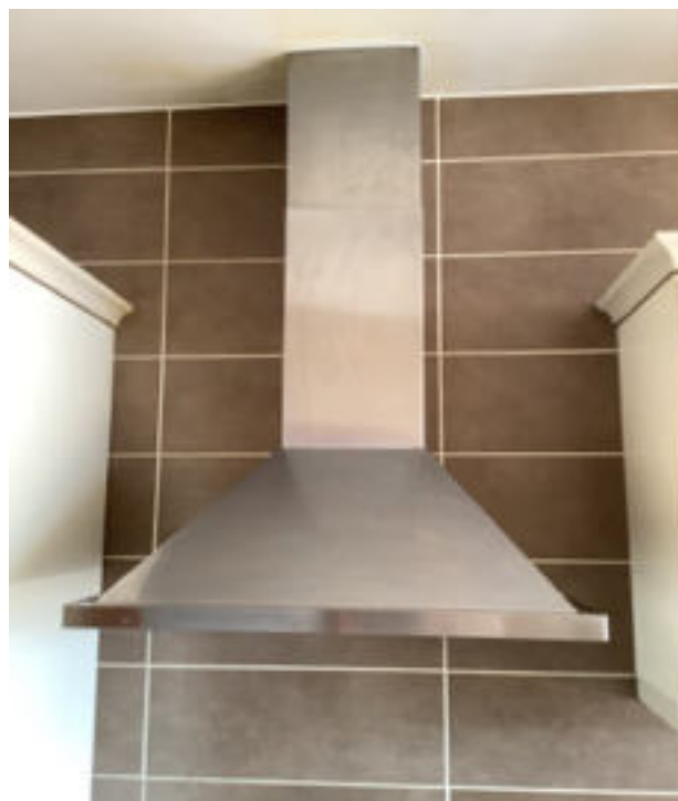
Photo 65 (Cuisine / Hotte aspirante / Bon état)
