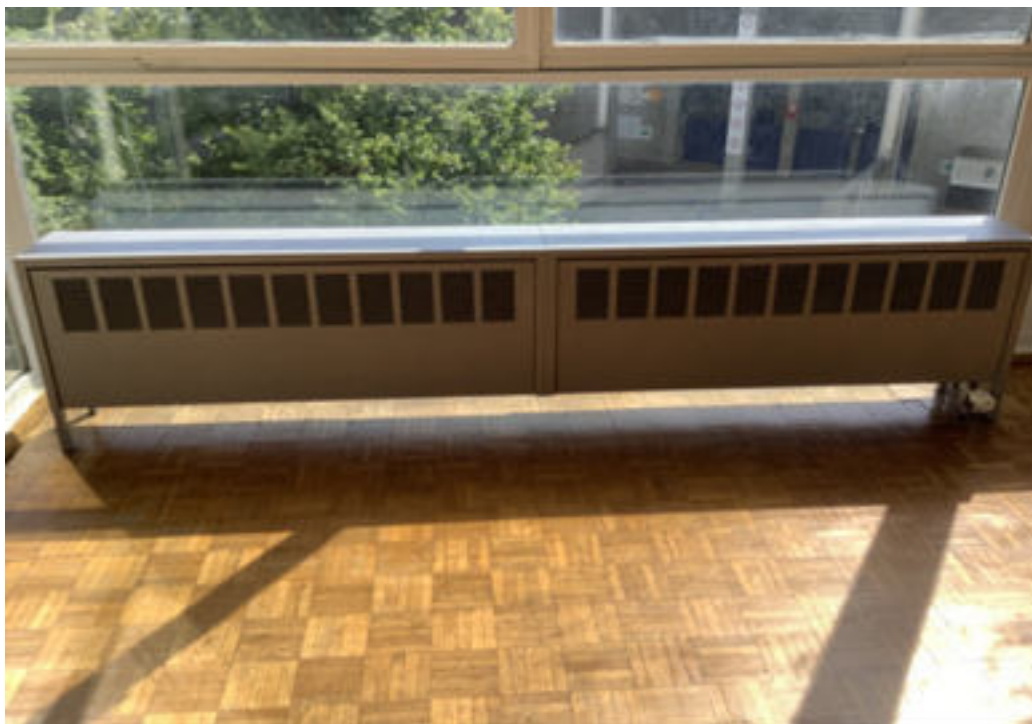
Photo 27 (Séjour / Radiateur(s) / Bon état)
