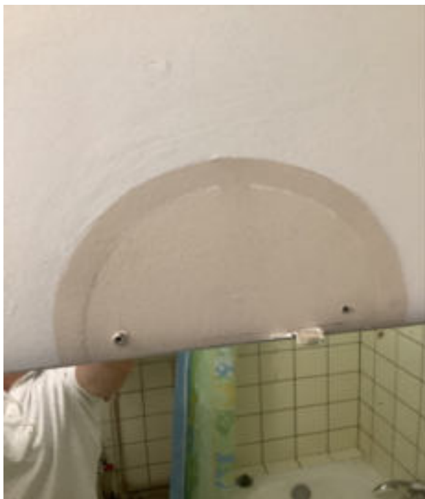
Photo 97 (Salle de bains / Murs / Trou(s))
