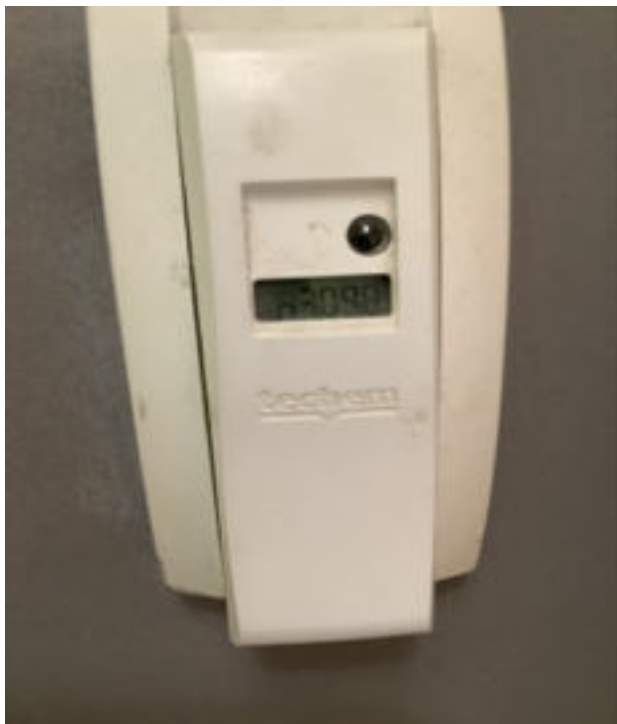
Photo 99 (Salle de bains / Radiateur(s) / Bon état)
