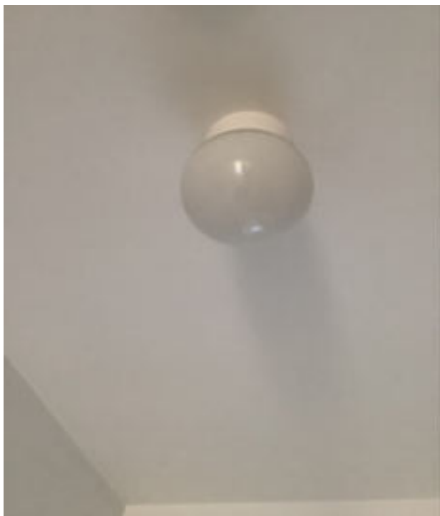
Photo 16 (Hall / Point lumineux / Bon état)
