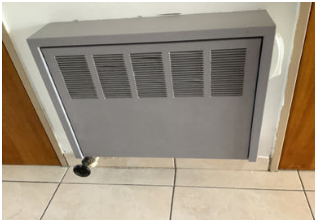
Photo 11 (Hall / Radiateur(s) / Bon état)
