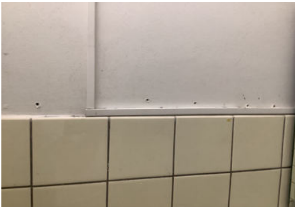
Photo 96 (Salle de bains / Murs / Trou(s))
