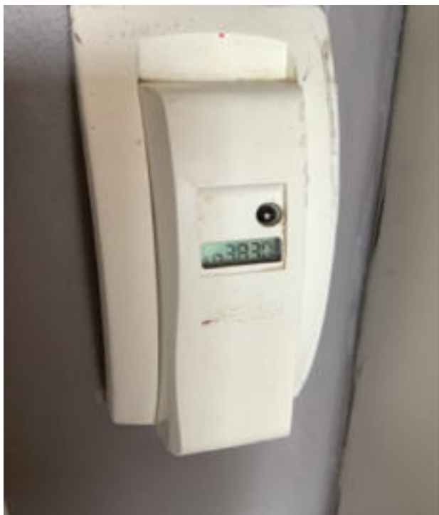
Photo 12 (Hall / Radiateur(s) / Bon état)
