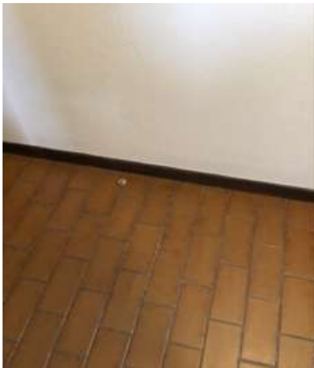
Photo 19 (Hall d'entrée / Plinthes / Etat d'usage)
