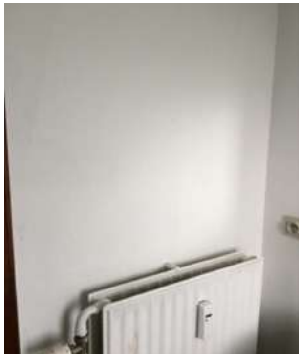
Photo 94 (Salle de bains / Murs / Etat d'usage)
