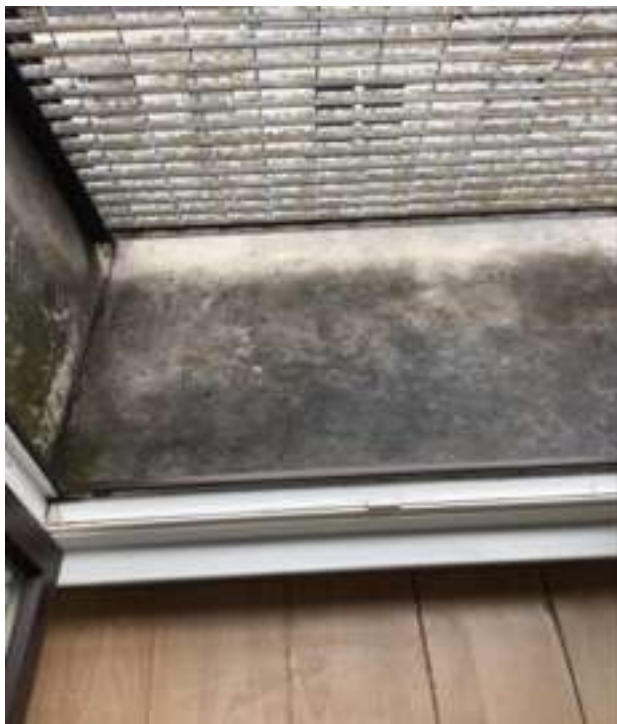
Photo 85 (WC / balcon / Mauvais état)
