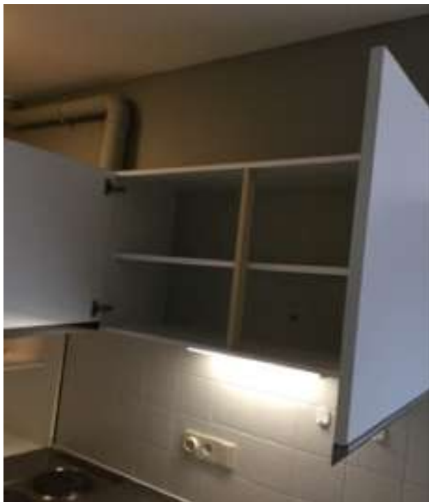
Photo 57 (Cuisine / Meubles / Vétustes)
