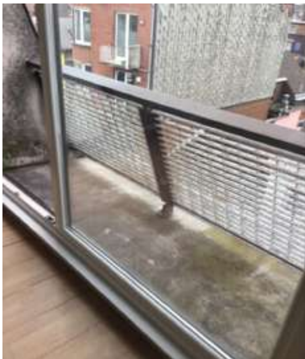
Photo 87 (WC / balcon / Mauvais état)
