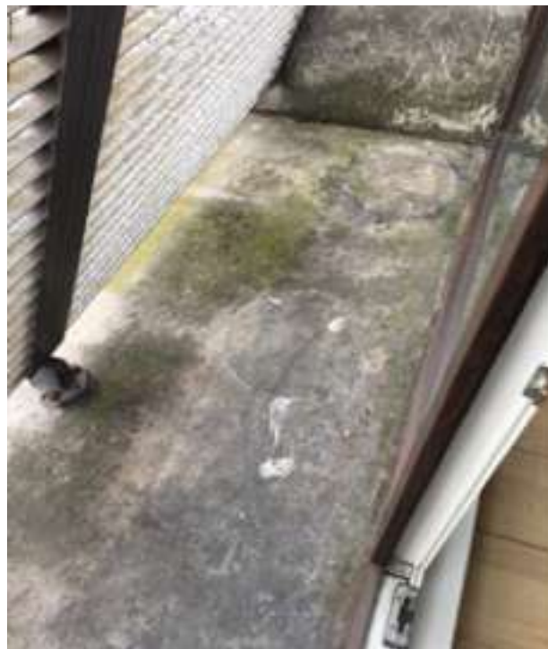
Photo 86 (WC / balcon / Mauvais état)
