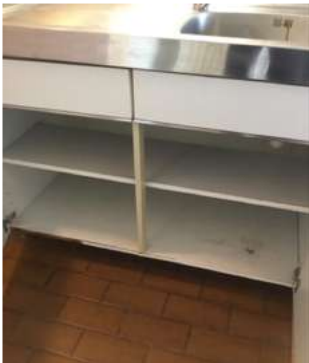
Photo 59 (Cuisine / Meubles / Vétustes)
