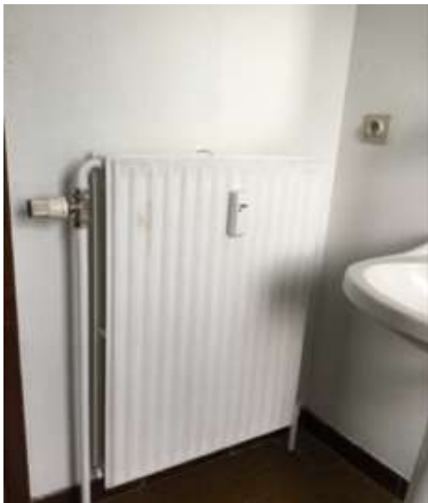
Photo 99 (Salle de bains / Radiateur(s) / Etat d'usage)
