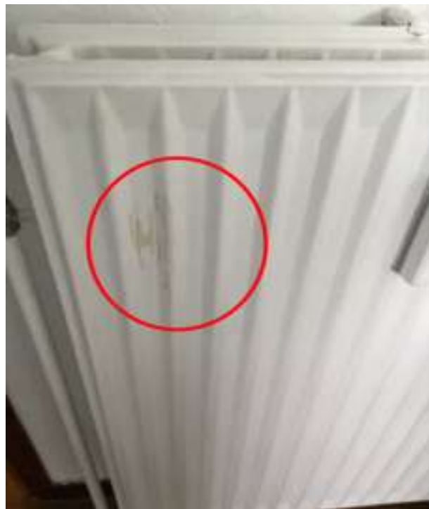
Photo 100 (Salle de bains / Radiateur(s) / Etat d'usage)
