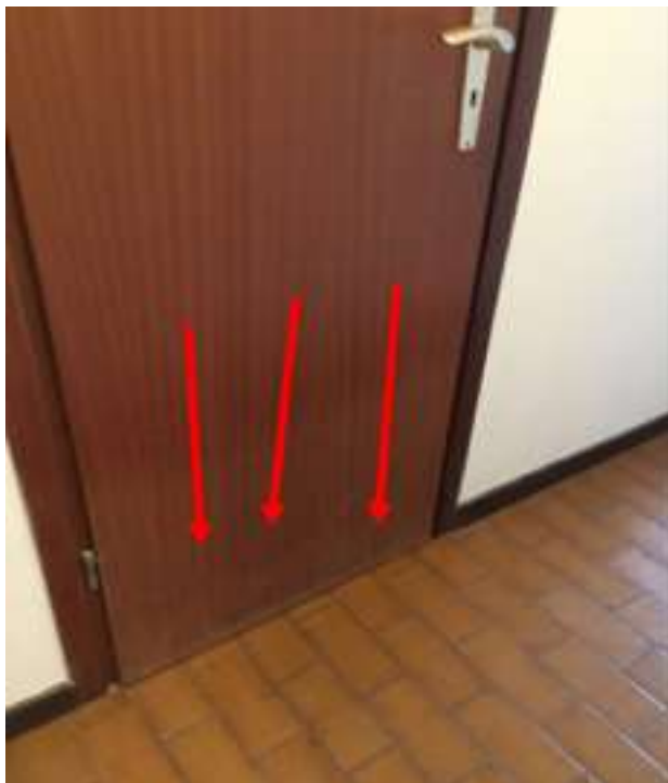
Photo 27 (Hall d'entrée / Porte(s) / Vétuste(s))
