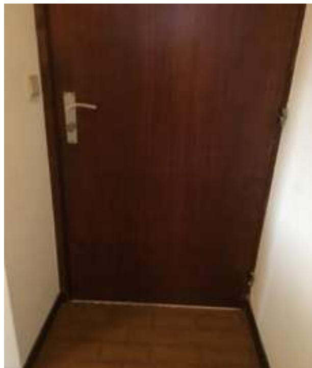
Photo 26 (Hall d'entrée / Porte(s) / Vétuste(s))
