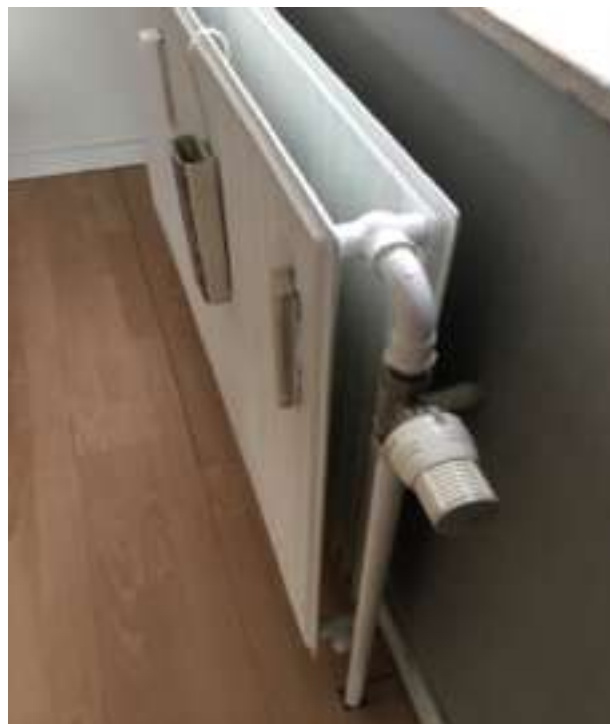
Photo 98 (Salle de bains / Radiateur(s) / Bon état)
