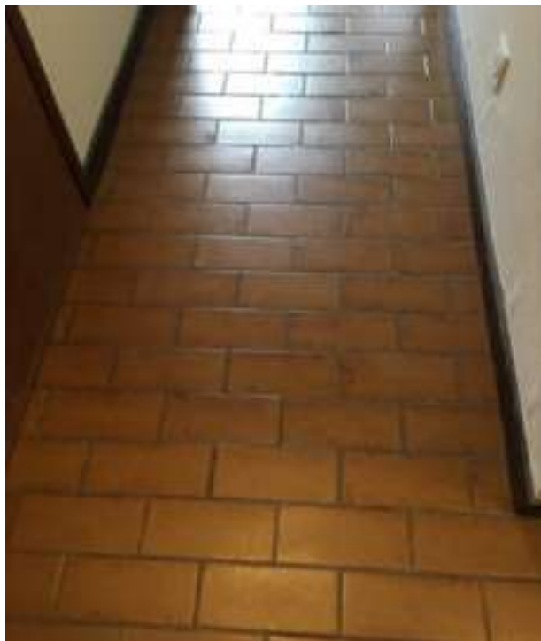
Photo 16 (Hall d'entrée / Sol / Etat d'usage)
