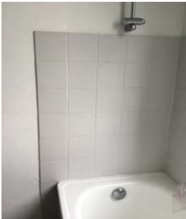
Photo 95 (Salle de bains / Murs / Etat d'usage)
