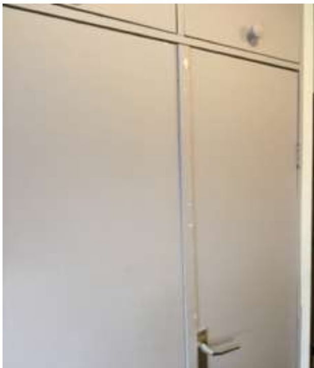
Photo 31 (Hall d'entrée / Armoires / Vétustes)
