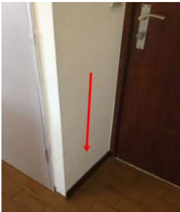
Photo 23 (Hall d'entrée / Murs / Vétuste )
