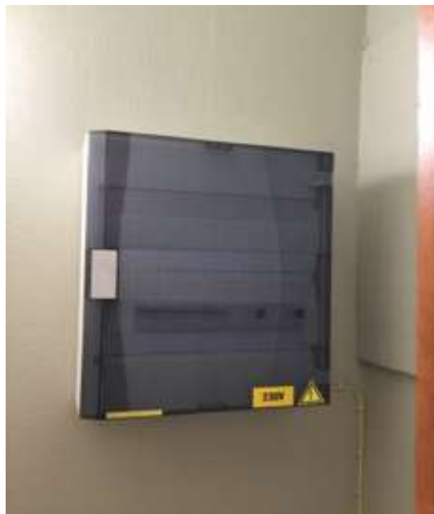
Photo 88 (WC / Coffret électrique / Bon état)
