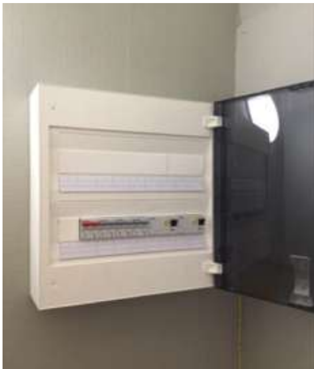
Photo 89 (WC / Coffret électrique / Bon état)
