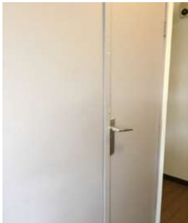
Photo 32 (Hall d'entrée / Armoires / Vétustes)
