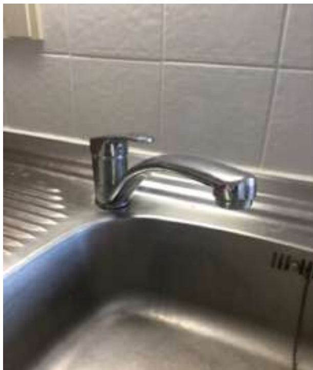
Photo 52 (Cuisine / Robinetterie / Etat d'usage)
