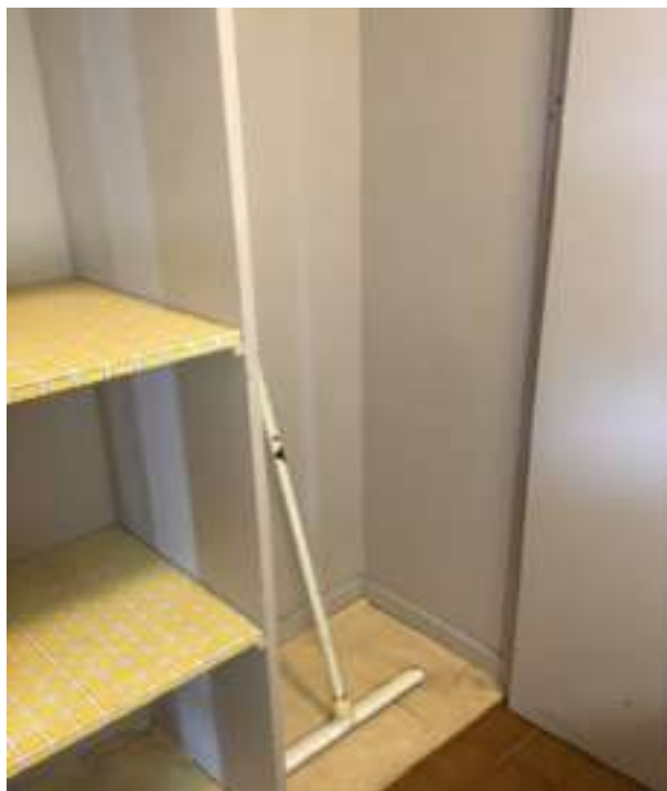
Photo 34 (Hall d'entrée / Armoires / Etat d'usage)
