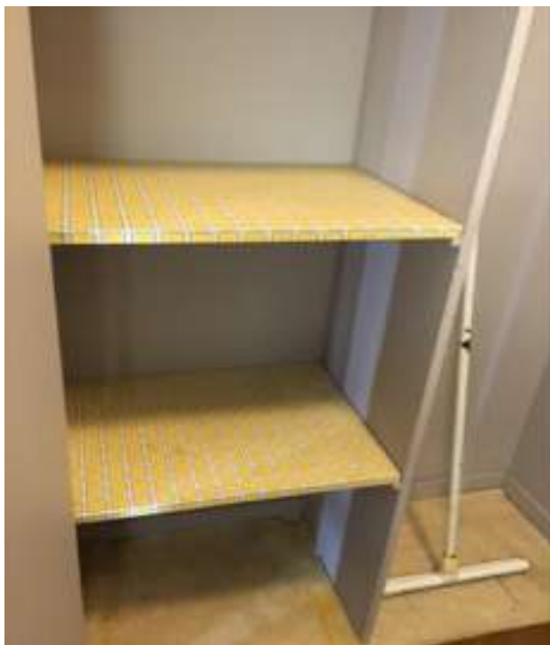
Photo 33 (Hall d'entrée / Armoires / Etat d'usage)
