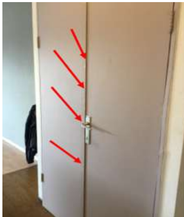
Photo 30 (Hall d'entrée / Armoires / Vétustes)
