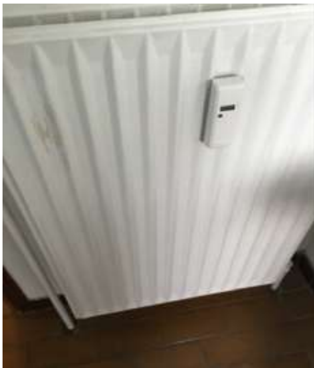
Photo 101 (Salle de bains / Radiateur(s) / Etat d'usage)
