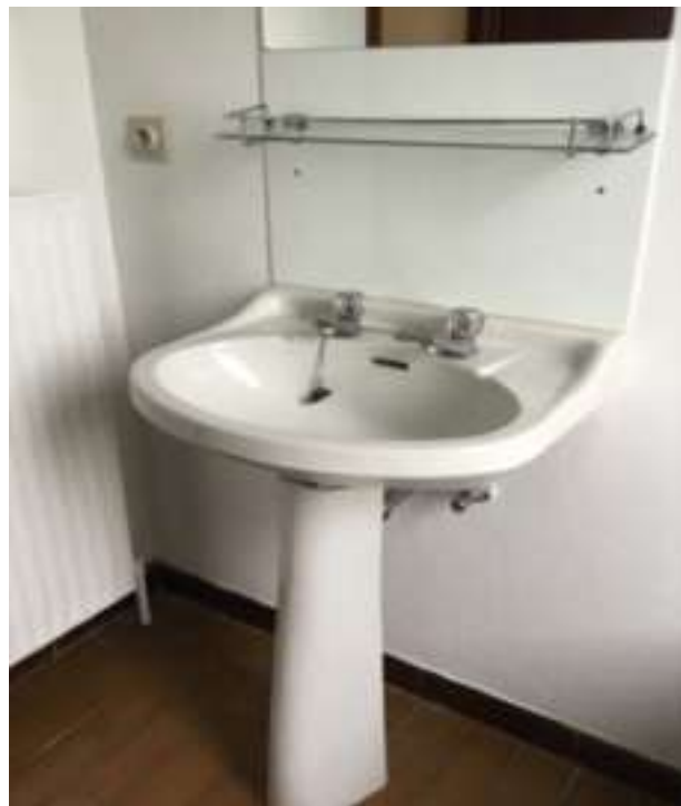
Photo 107 (Salle de bains / Lavabo / Etat d'usage)
