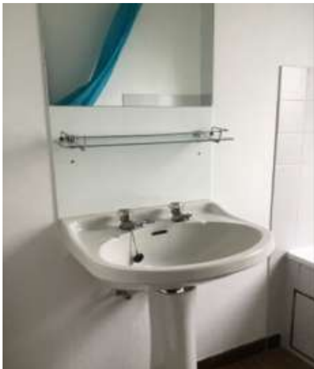
Photo 106 (Salle de bains / Lavabo / Etat d'usage)
