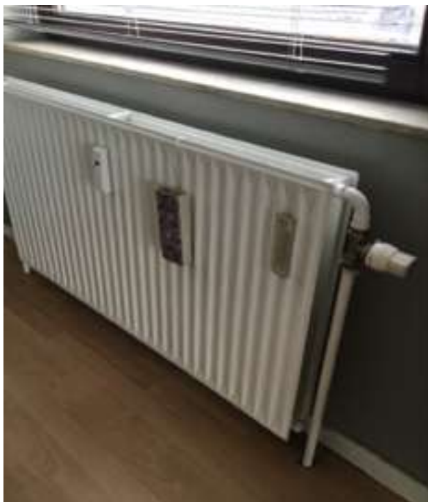
Photo 97 (Salle de bains / Radiateur(s) / Bon état)
