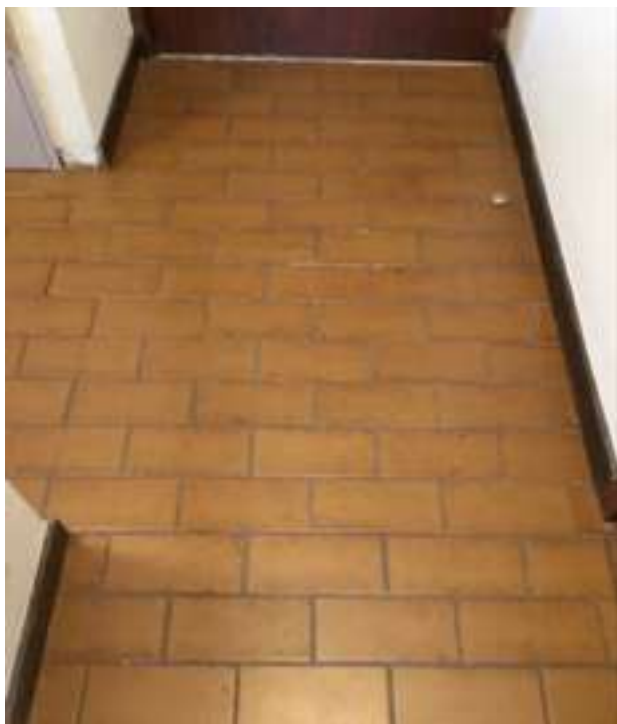
Photo 17 (Hall d'entrée / Sol / Etat d'usage)
