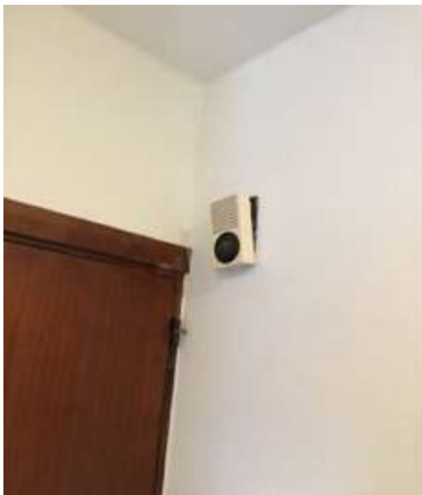
Photo 25 (Hall d'entrée / Sonnette / Vétuste )
