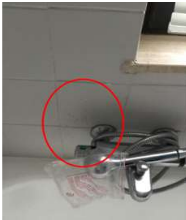
Photo 96 (Salle de bains / Murs / Etat d'usage)
