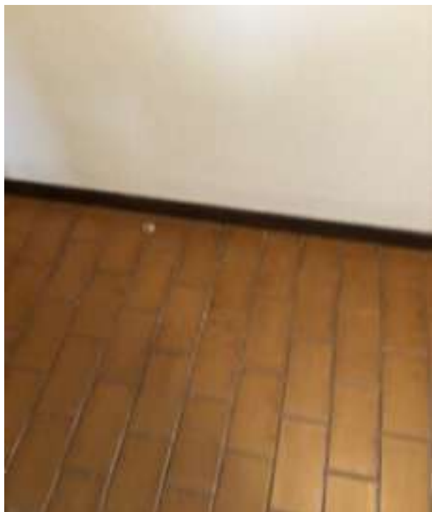
Photo 18 (Hall d'entrée / Plinthes / Etat d'usage)
