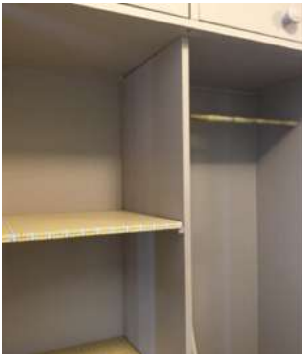
Photo 35 (Hall d'entrée / Armoires / Etat d'usage)
