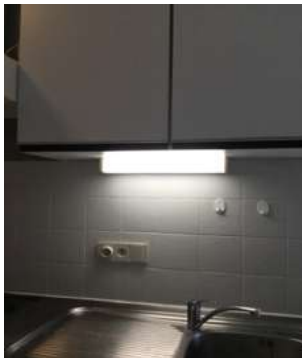
Photo 46 (Cuisine / Point lumineux / Vétuste)
