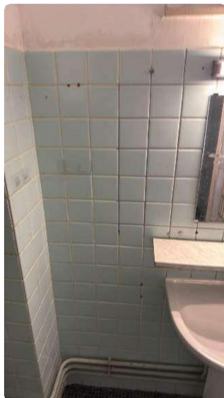
Salle de bains - photo 22
