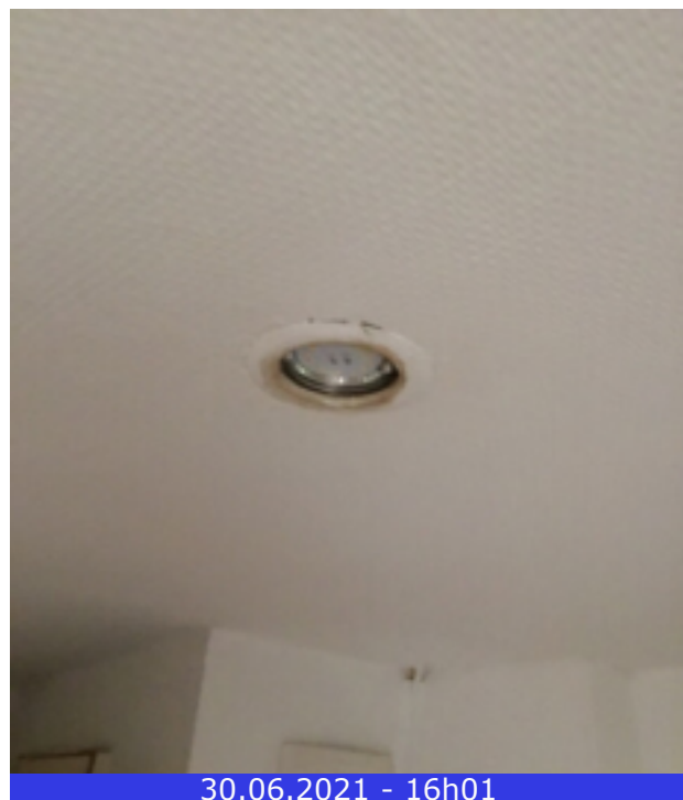
Photo 25 (Salle de bains / Point lumineux / Bon état)
