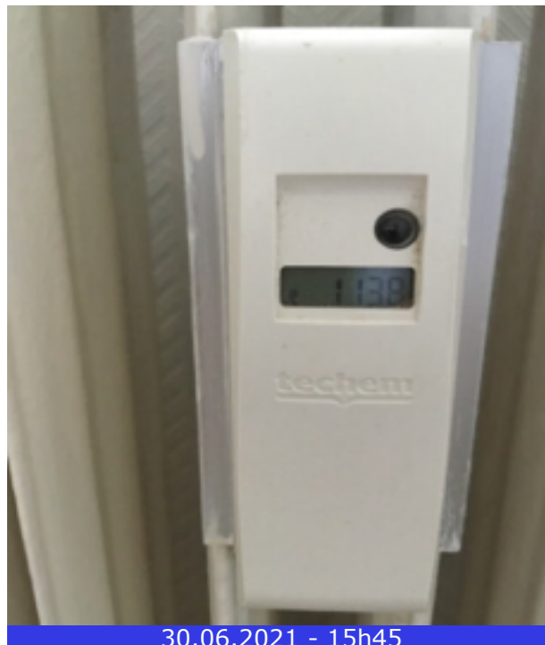
Photo 90 (Chambre / Radiateur(s) / Bon état)
