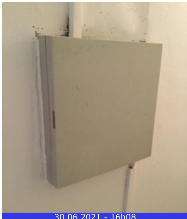
Photo 44 (Débaras / boîte à fusibles / Etat d'usage)
