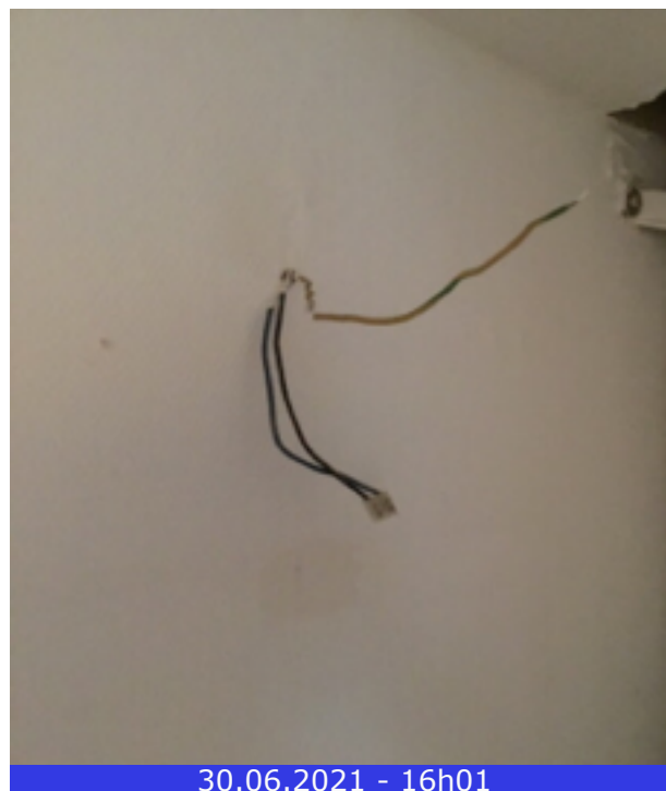
Photo 26 (Salle de bains / Point lumineux / Bon état)
