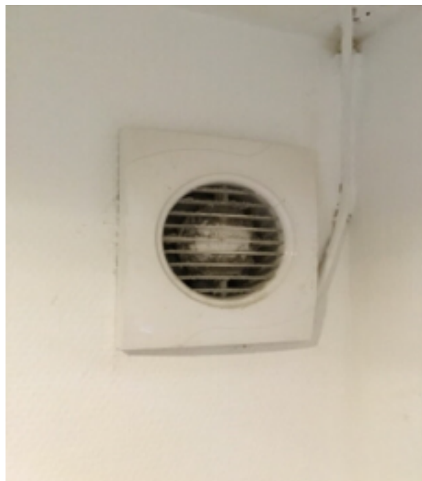
Photo 34 (Salle de bains / Ventilation / Ne fonctionne plus)
