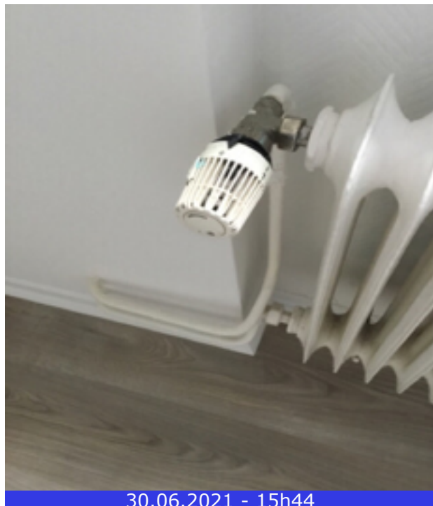
Photo 89 (Chambre / Radiateur(s) / Bon état)
