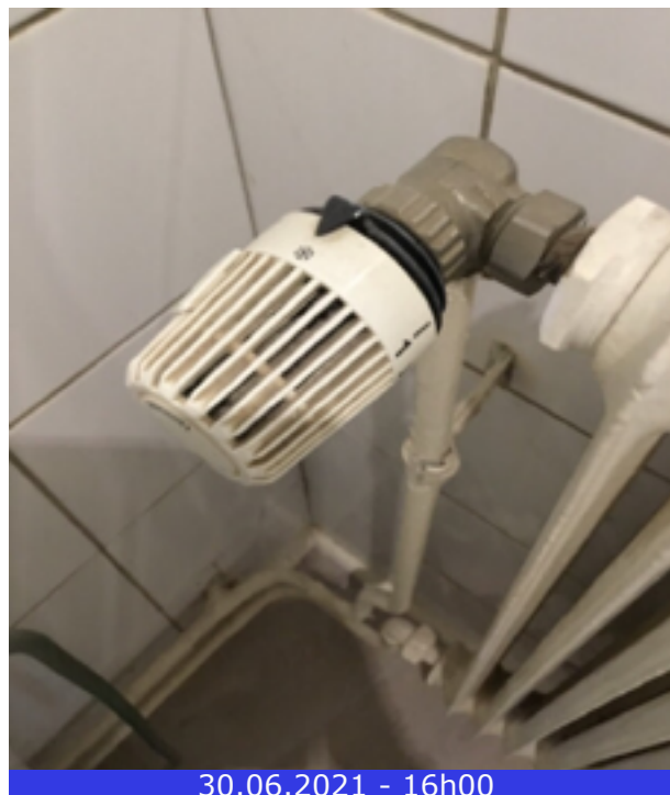
Photo 22 (Salle de bains / Radiateur(s) / Etat d'usage)
