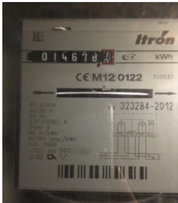
Photo 2 (Compteur / Electricité (jour))
