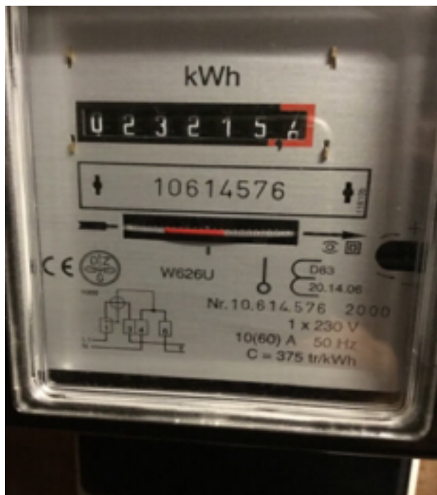
Photo 3 (Compteur / Electricité (nuit))
