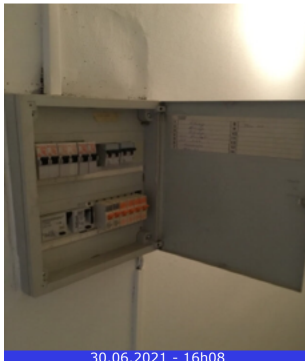
Photo 45 (Débaras / boîte à fusibles / Etat d'usage)
