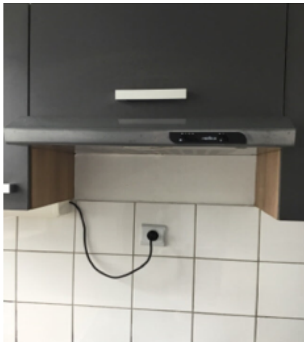
Photo 75 (Cuisine / Hotte aspirante / Bon état)
