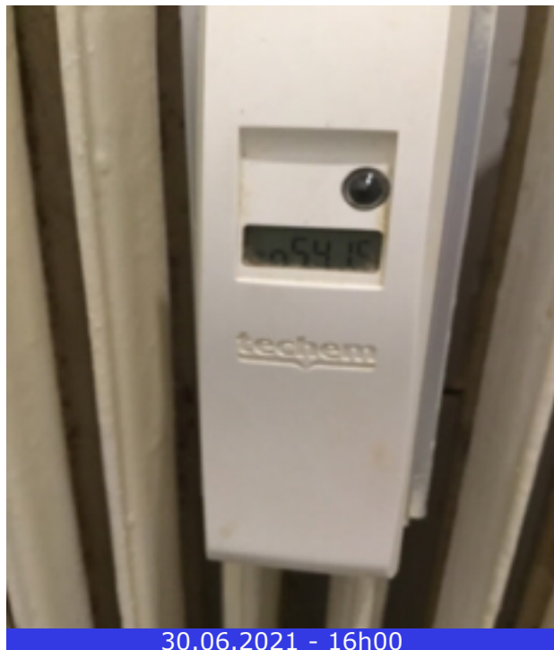
Photo 23 (Salle de bains / Radiateur(s) / Etat d'usage)
