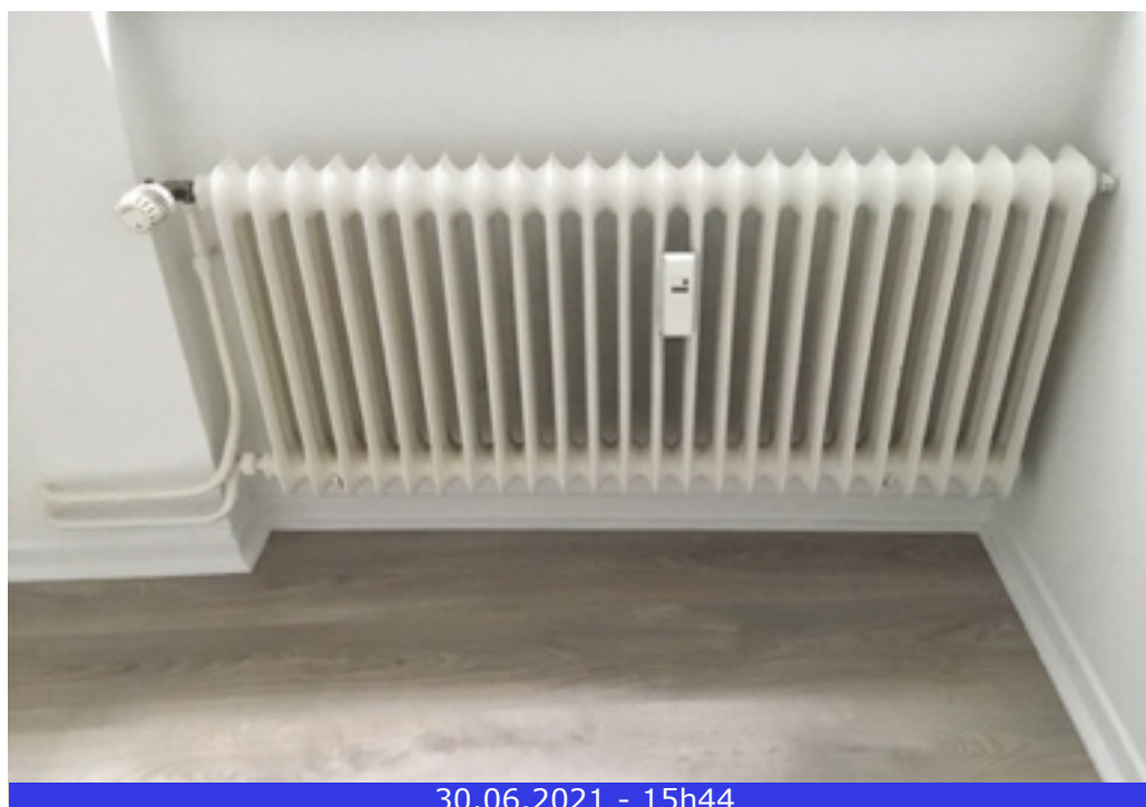
Photo 88 (Chambre / Radiateur(s) / Bon état)
