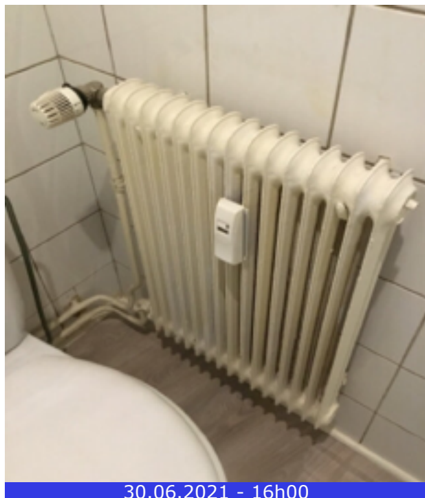
Photo 21 (Salle de bains / Radiateur(s) / Etat d'usage)
