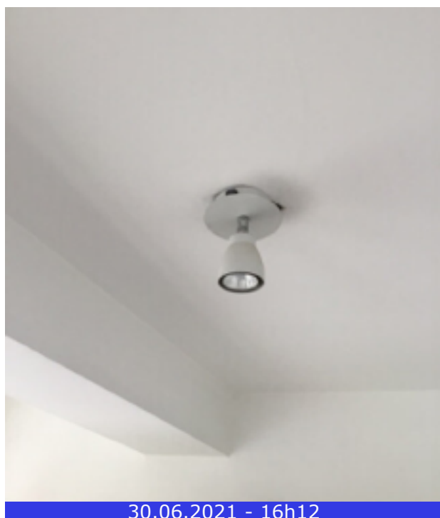
Photo 63 (Cuisine / Point lumineux / Bon état)
