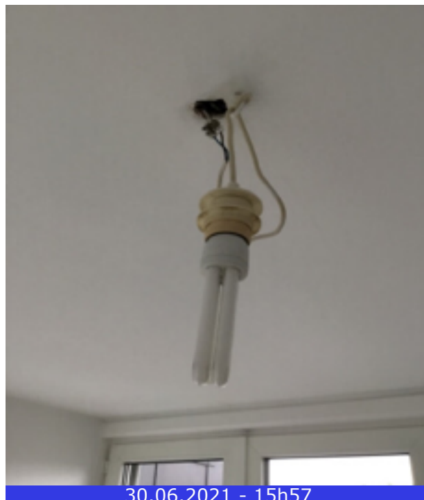
Photo 103 (Chambre (de derrière) / Point lumineux / Bon état)
