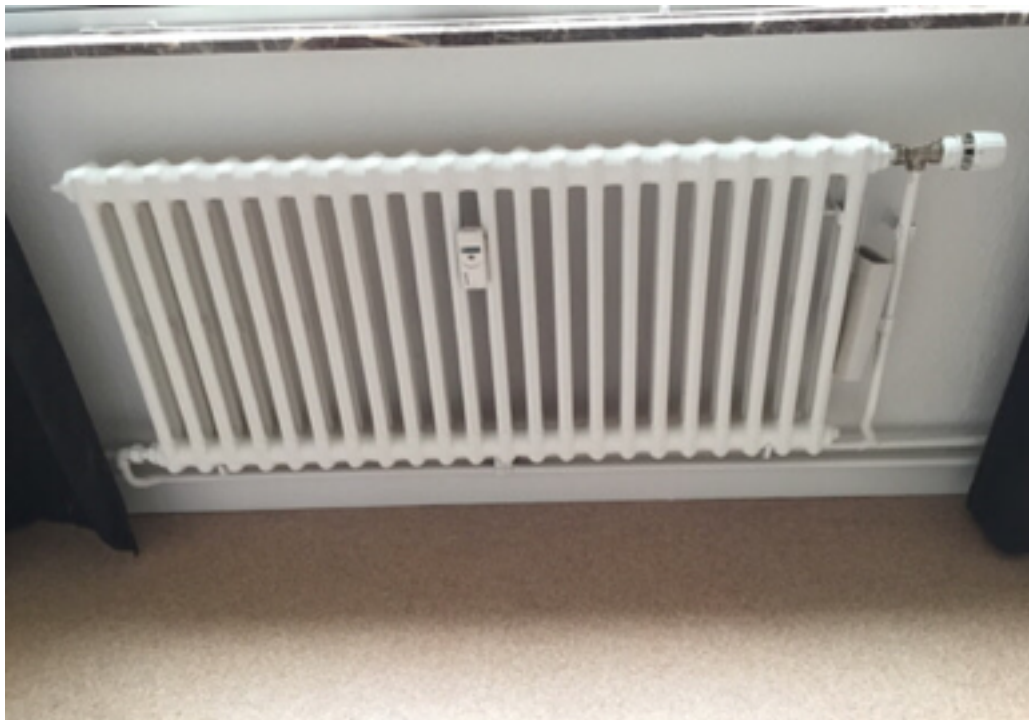
Photo 96 (Chambre / Radiateur(s) / Bon état)
