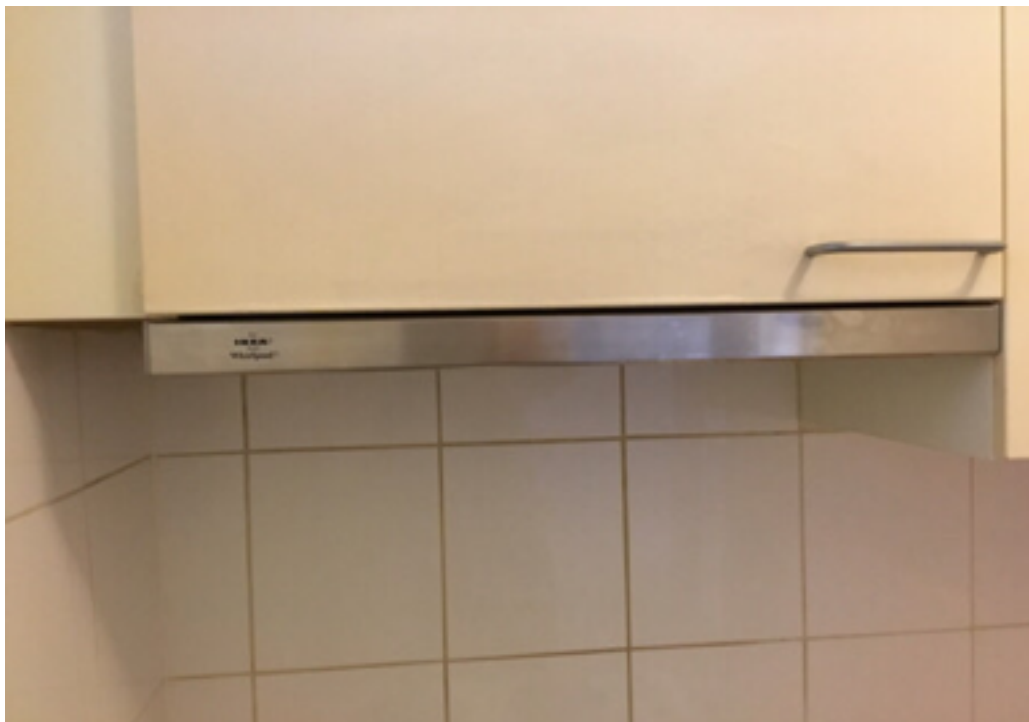
Photo 53 (Cuisine / Hotte aspirante / Bon état)
