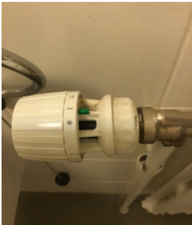
Photo 68 (Salle de bains / Radiateur(s) / Bon état)
