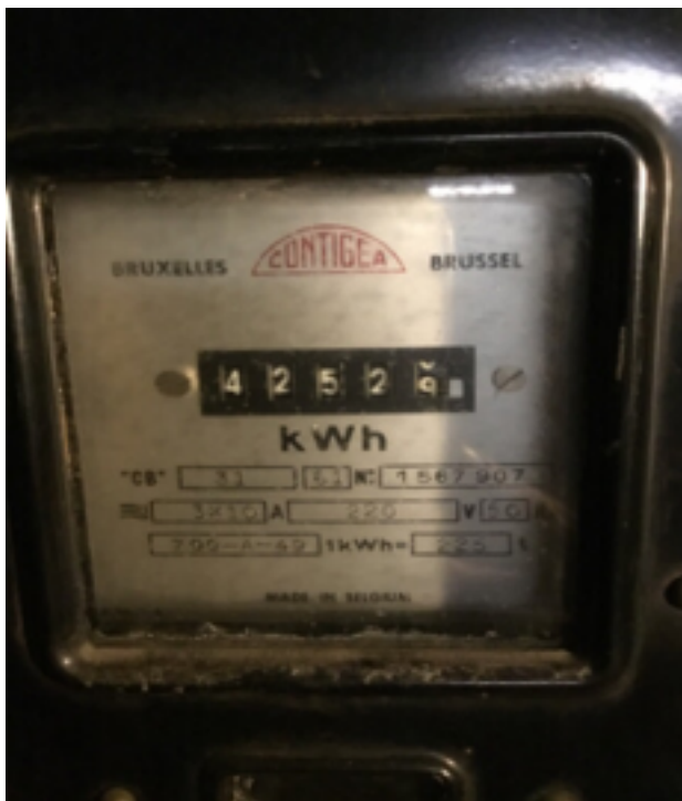
Photo 1 (Compteur / Electricité (jour))
