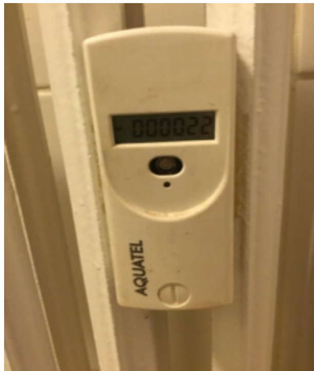
Photo 69 (Salle de bains / Radiateur(s) / Bon état)
