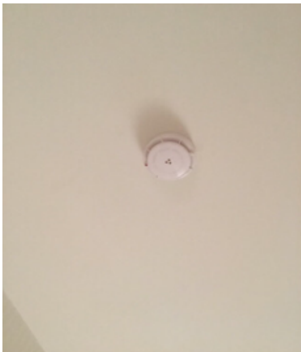
Photo 21 (Hall / détecteur incendie / Bon état)
