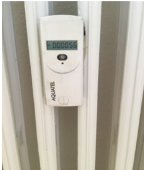
Photo 98 (Chambre / Radiateur(s) / Bon état)
