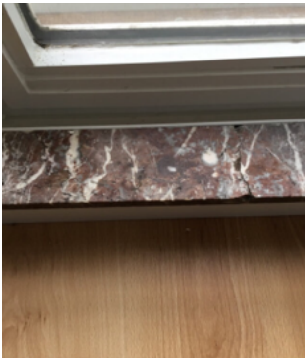
Photo 34 (Séjour / dégâts / Élément(s) endommagé(s))
