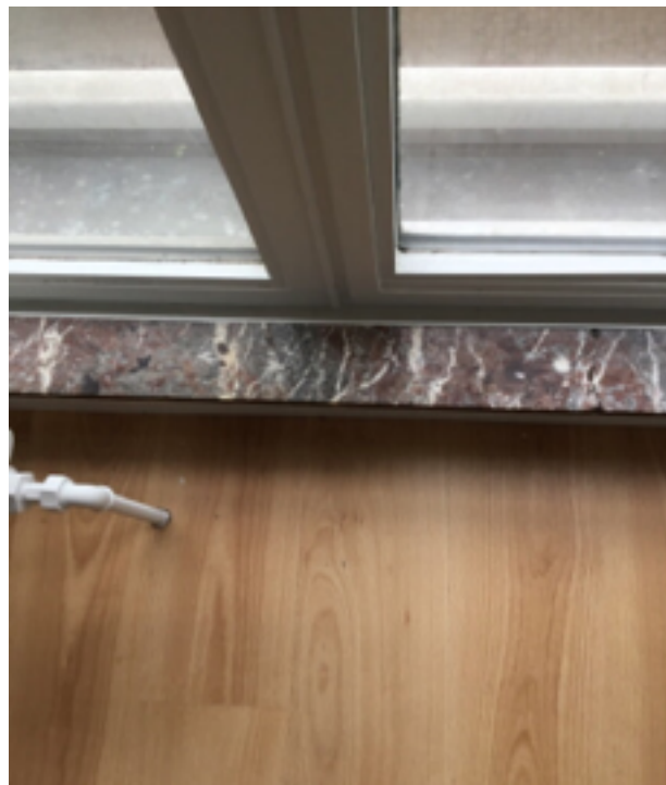
Photo 35 (Séjour / dégâts / Élément(s) endommagé(s))
