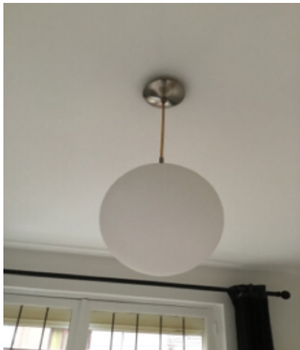
Photo 100 (Chambre / Point lumineux / Bon état)
