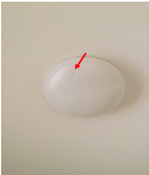
Photo 44 (Cuisine / Point lumineux / Bon état)
