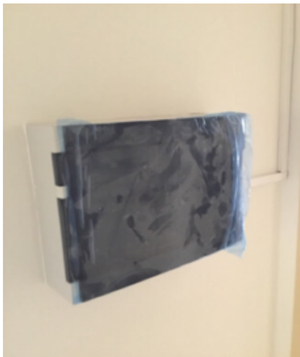
Photo 20 (Hall / coffret électrique / Bon état)
