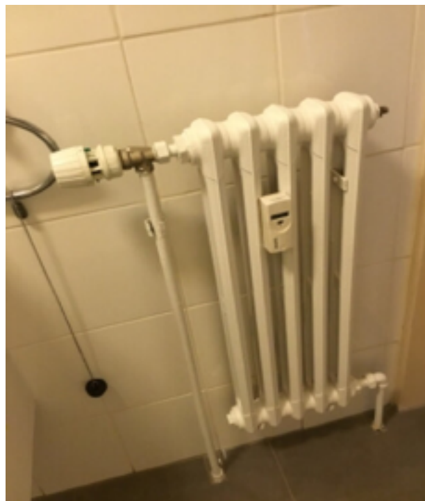
Photo 67 (Salle de bains / Radiateur(s) / Bon état)
