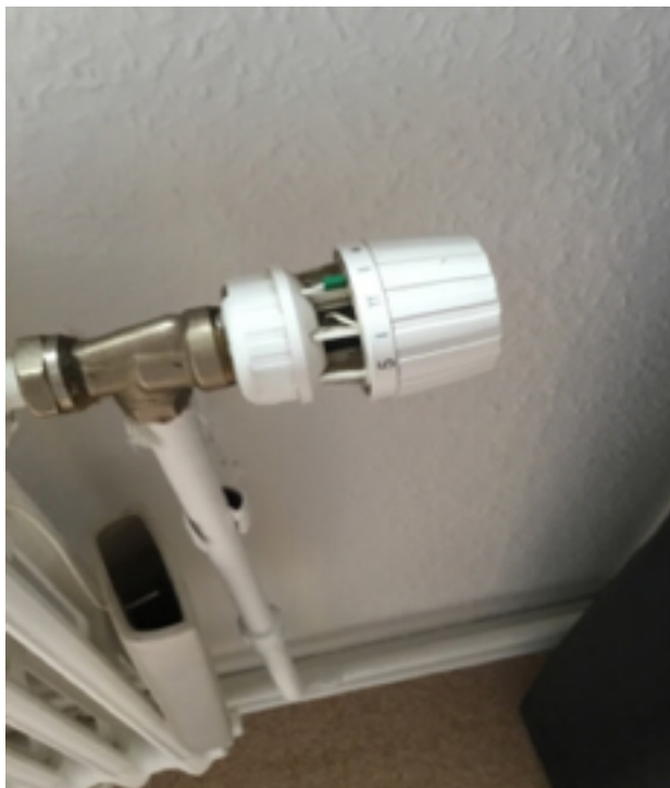
Photo 97 (Chambre / Radiateur(s) / Bon état)
