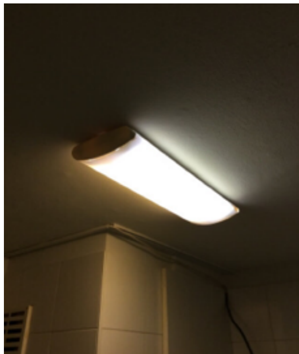
Photo 71 (Salle de bains / Point lumineux / Bon état)
