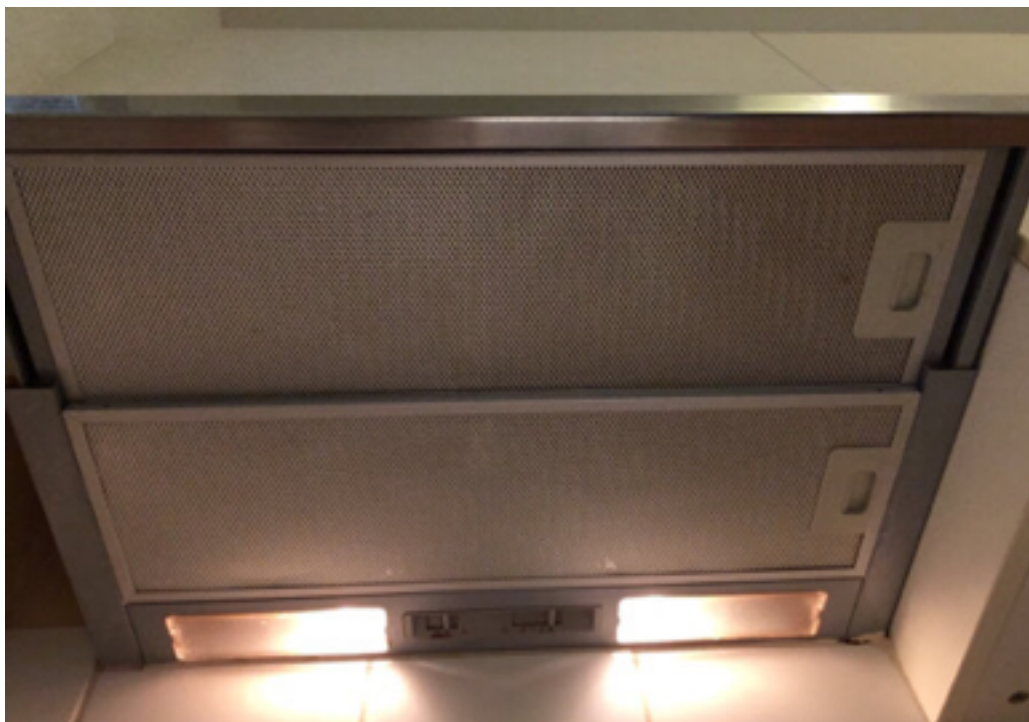
Photo 54 (Cuisine / Hotte aspirante / Bon état)
