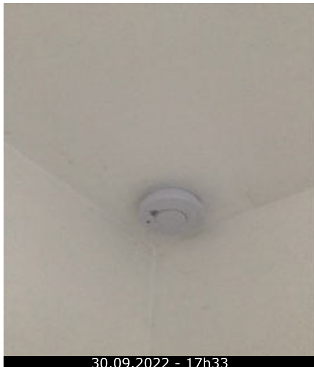
Photo 49 (Cuisine / détecteur incendie / Bon état)
