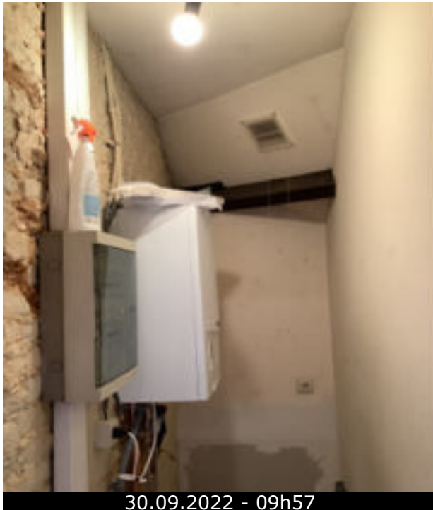
Photo 80 (Photo générale / Local technique)
