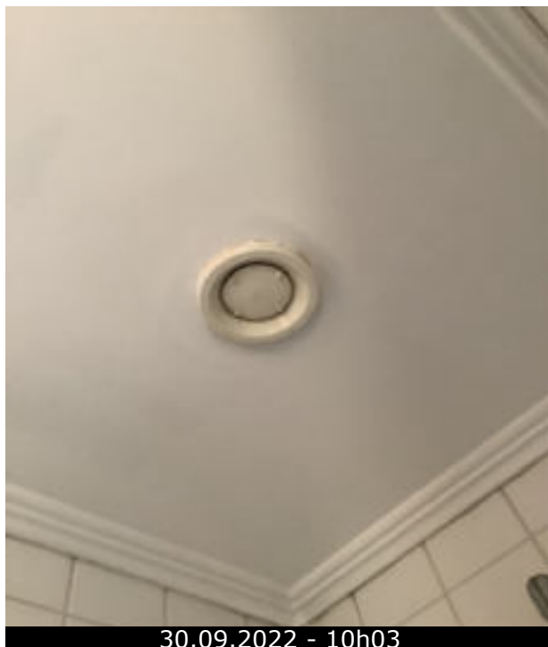
Photo 77 (Salle de bains / Ventilation / Bon état)
