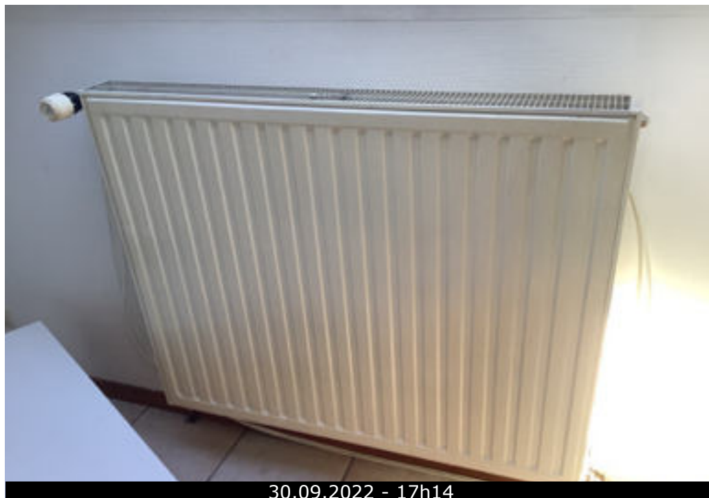
Photo 11 (Séjour / Radiateur(s) / Bon état)
