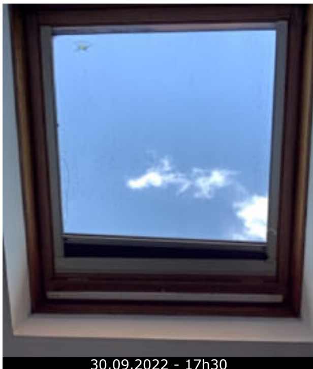
Photo 43 (Cuisine / Fenêtre(s) / Bon état)
