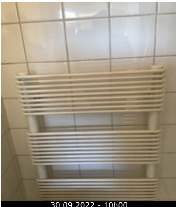
Photo 67 (Salle de bains / Radiateur(s) / Bon état)
