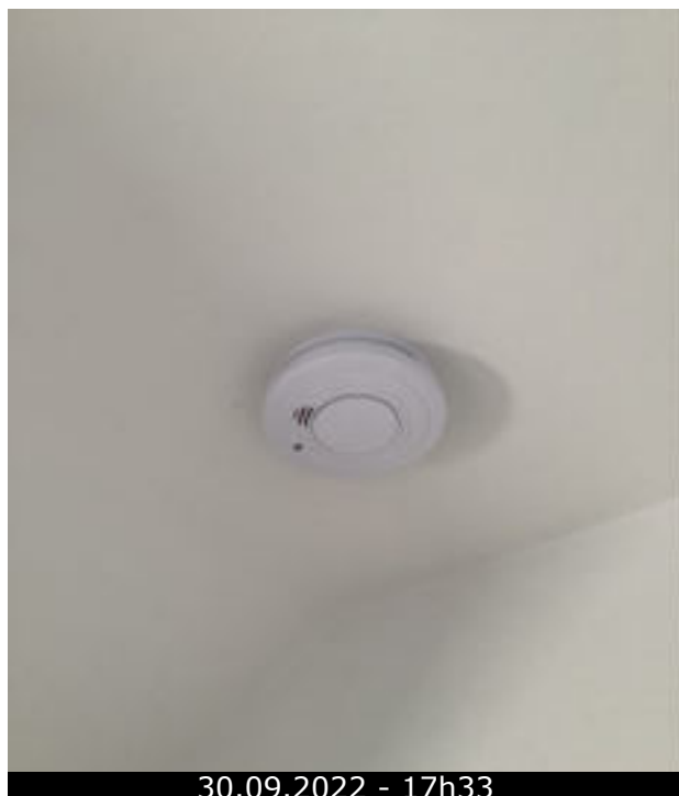
Photo 24 (Séjour / détecteur incendie / Bon état)
