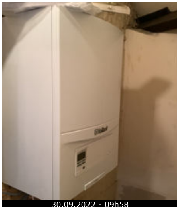
Photo 84 (Local technique / chaudière / Bon état)
