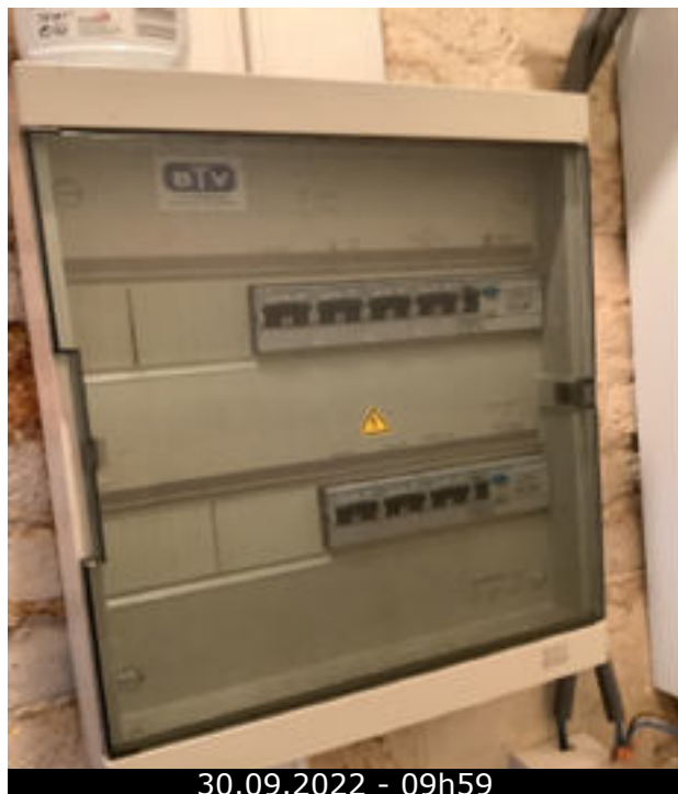
Photo 86 (Local technique / tableau électrique / Bon état)
