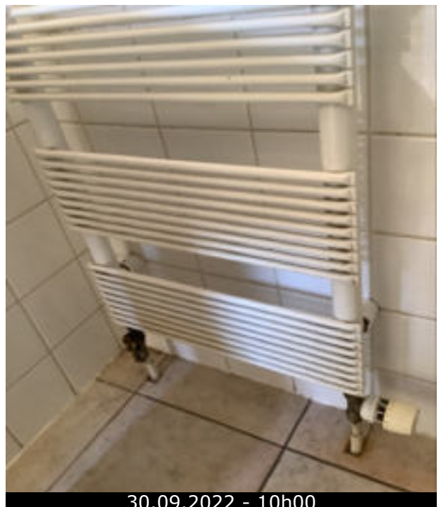
Photo 68 (Salle de bains / Radiateur(s) / Bon état)
