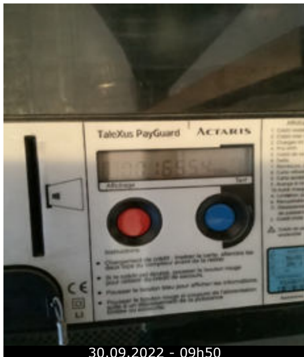
Photo 1 (Compteur / Electricité (HP))
